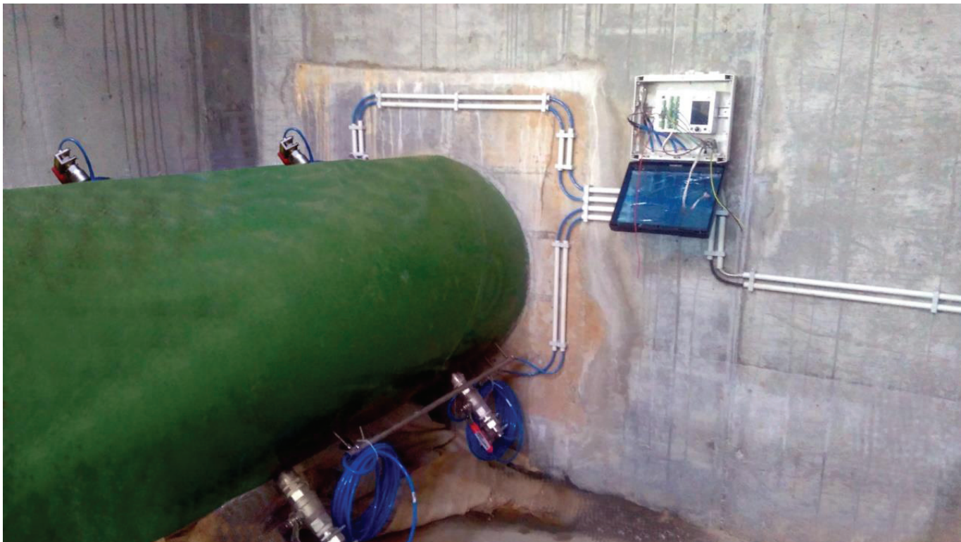
Instalação em conduta DN 1200, com 2 pares de sensores (2 percursos)
